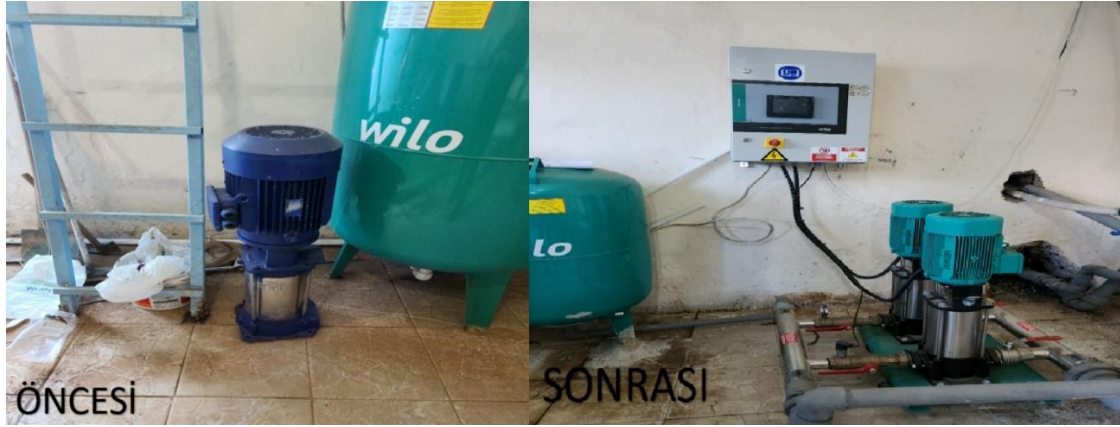
Görsel 12 Su pompasına invertör uygulaması
